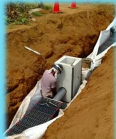
浸透トレンチ
